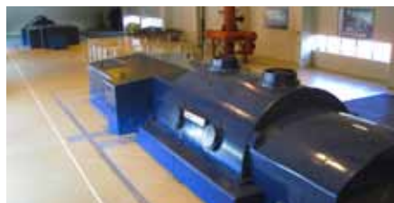
Foto: Die Maschinenhalle mit den zwei Turbinen und Generatoren des geothermalen Kraftwerks am Krafla
