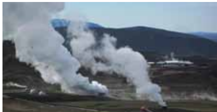
Foto: Ein Netz von 17 Bohrlöchern und Leitungen sammelt den Dampf für das Kraftwerk.
